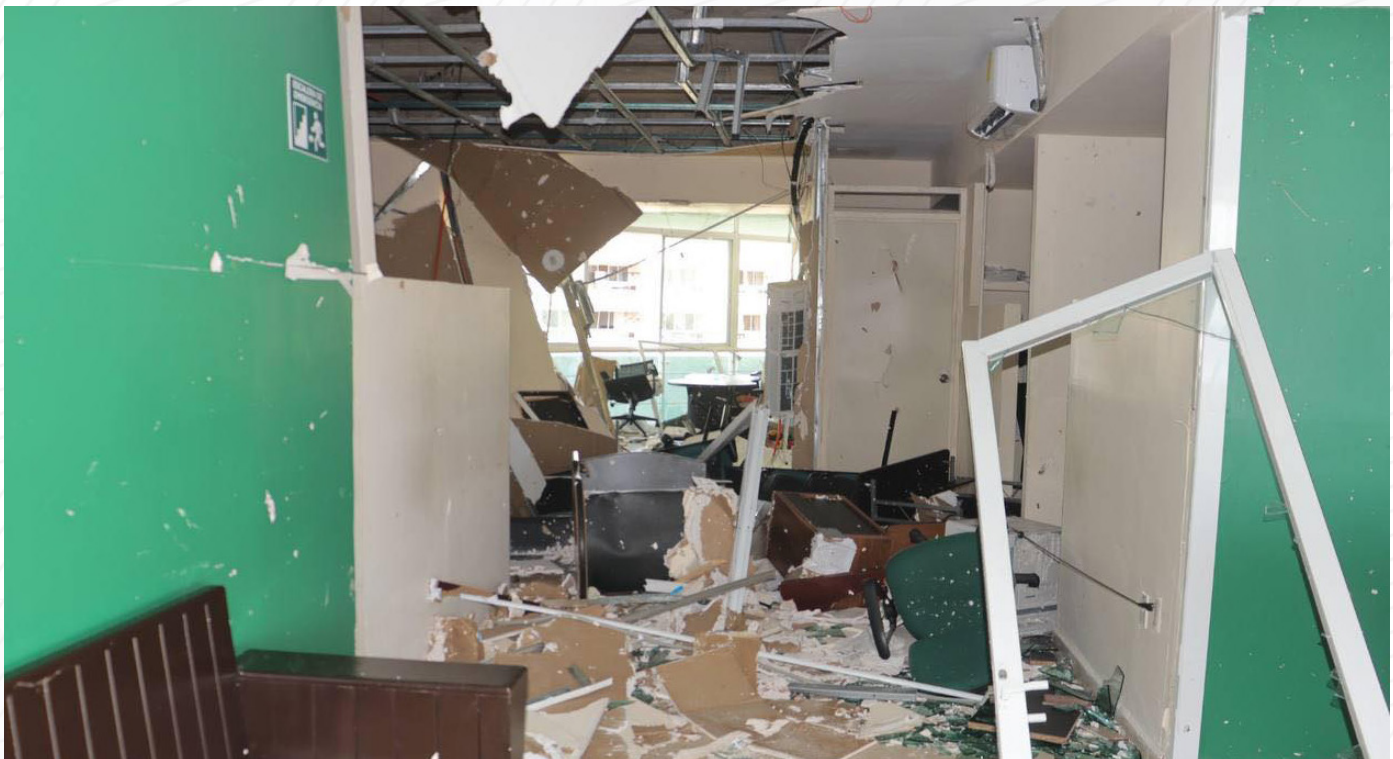
Graves daños a la infraestructura física, tecnológica y al mobiliario convencional causados por Huracán Otis
