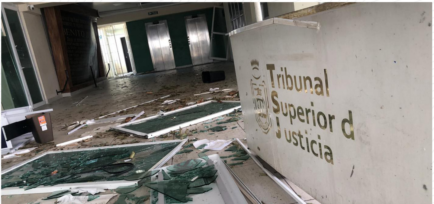
Graves daños a la infraestructura física, tecnológica y al mobiliario convencional causados el por Huracán Otis
